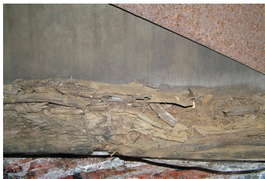
Syllen var rötskadad.
