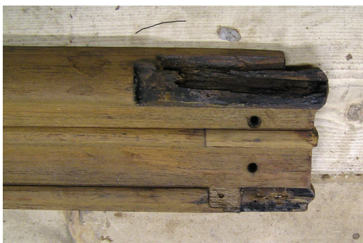
Många av krönlisterna var skadade i ändarna.
