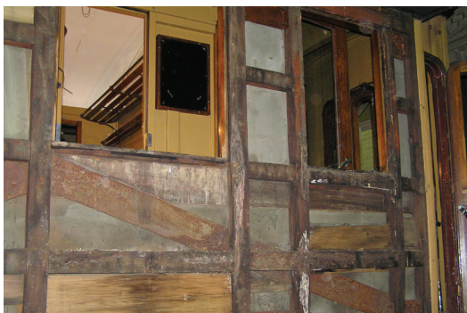
Stommen uppvisade många skador.
