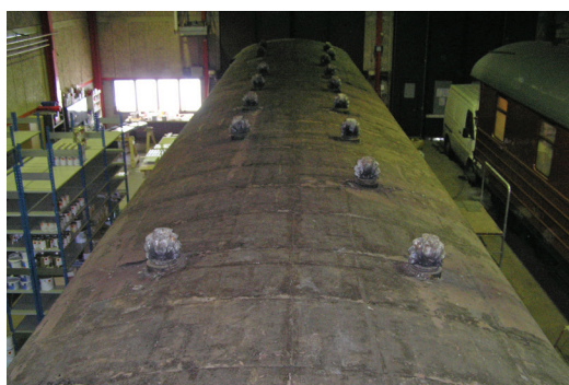
Takväven var helt uttjänt, brädorna under skadade och likaså takventilernas infästningar.
